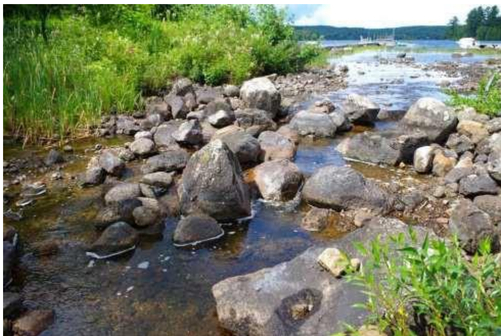
Photo 3 L'exutoire est composé de pierres de forte dimension. Durant les périodes d'étiage, la percolation importante au travers des roches rend la libre circulation du poisson impossible.
